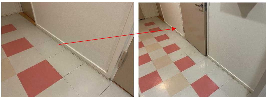
Kuva 3. Ilmaisus 2. Homekoira ilmaisi käytävällä 112_5 tilan 122 vastaista väliseinää lattian rakenneliitoksesta. Väliseinä (ei rakenneleikkauskuvaa saatavilla) on isännöitsijältä saadun tiedon mukaan kantava rakenne ja perustettu lattiapinnan alapuolelta.
