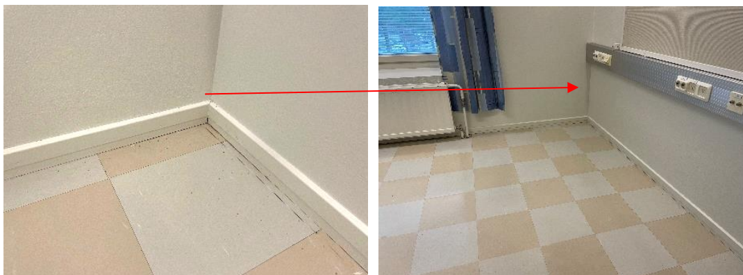
Kuva 2. Ilmaisus 1. Homekoira ilmaisi toimistohuoneessa 123 ulkonurkkaa lattian rakenneliitoksesta.
